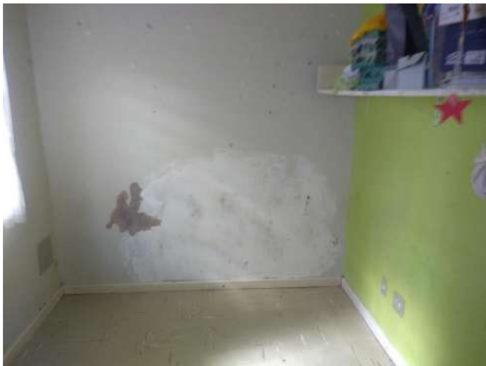
Imagem VII– Danos paredes sala de leitura.
