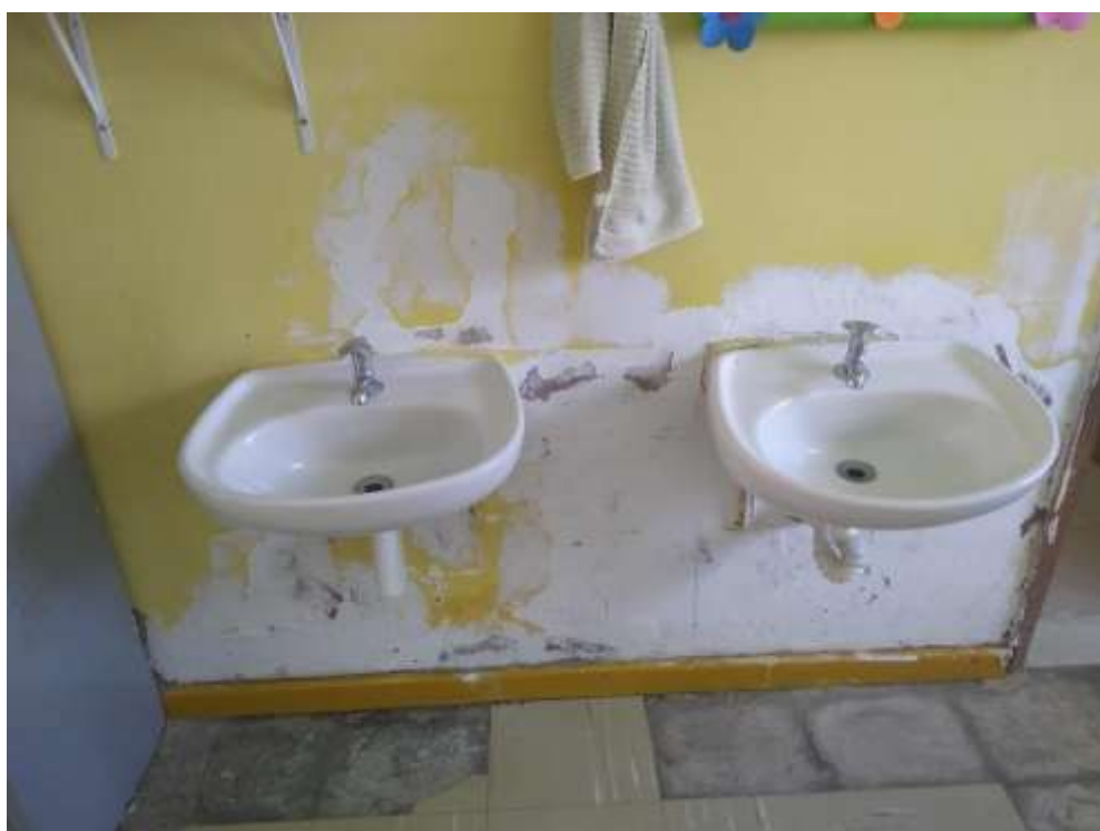
Imagem II– Danos paredes berçário II-01.
