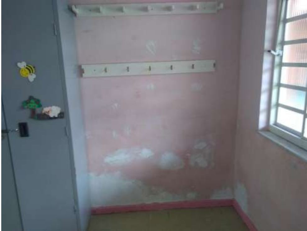
Imagem IX– Danos paredes Maternal I-02.
