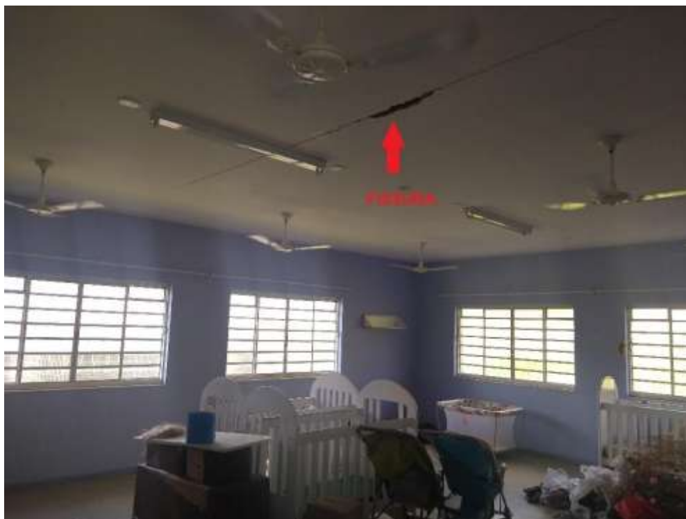
Imagem I – Fissura teto berçário I.
