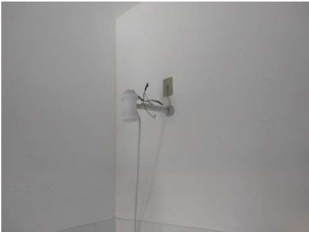
Imagem IV– Fiação chuveiro elétrico banheiro.
