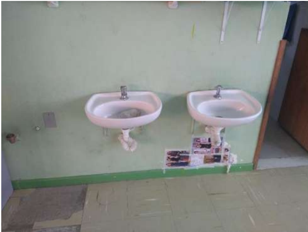
Imagem V– Danos piso e parede Berçário II-02.
