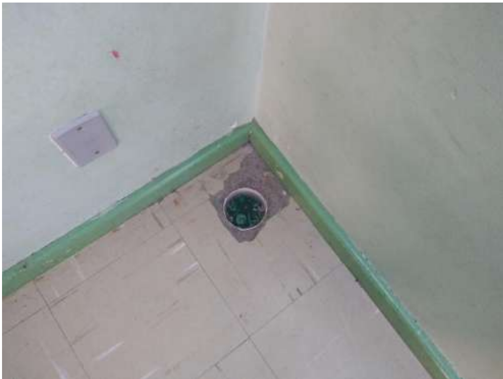
Imagem VI– Falta de tampa ralo Berçário II-02.
