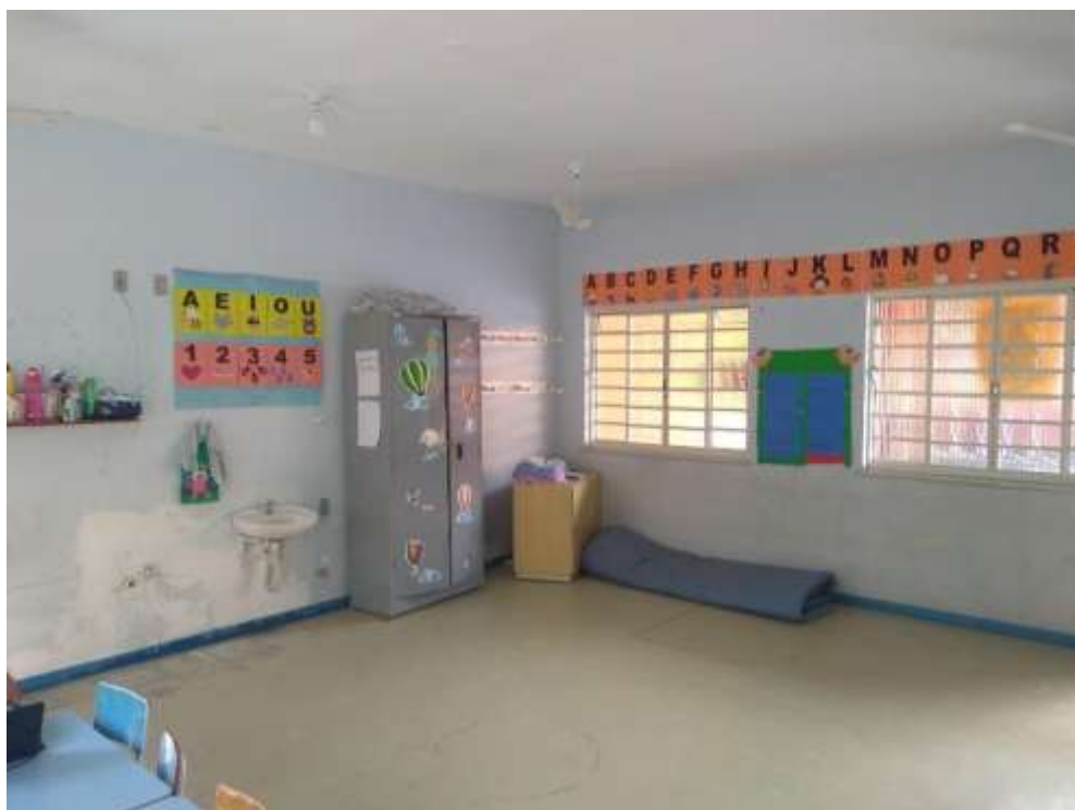
Imagem VIII– Danos paredes e falta de lavatório Maternal I-01.
