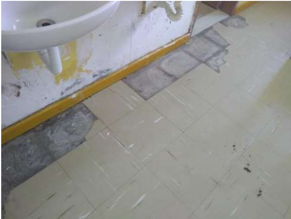
Imagem III– Danos piso berçário II-01.
