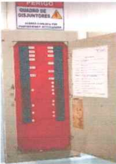
QUADRO DE DISJUNTORES
