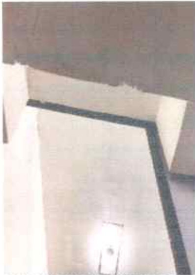
VIGA CORTADA ENFERMARIA
