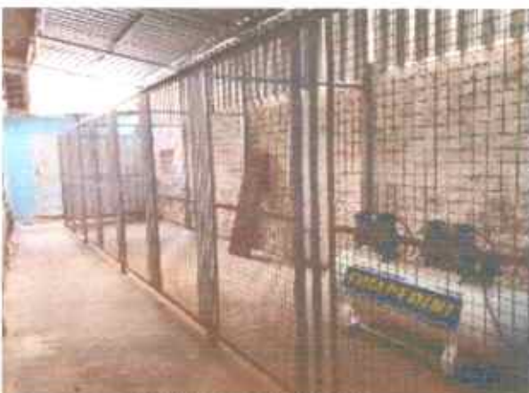
ÁREA DO COMPRESSOR
