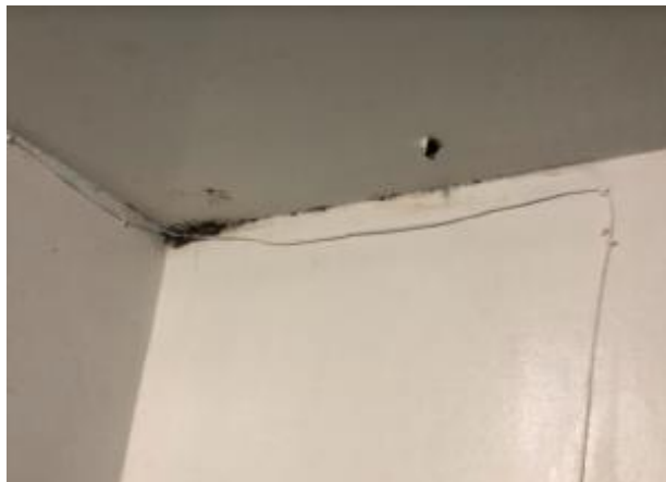
PAREDE AO LADO DA VIGA CORTADA
