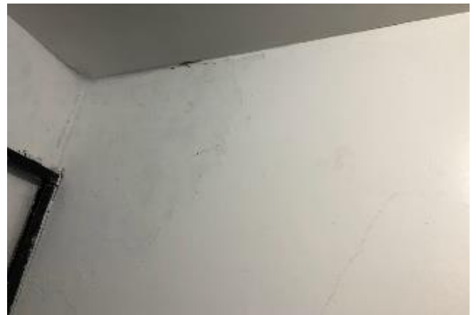
PAREDE AO LADO DA VIGA CORTADA
