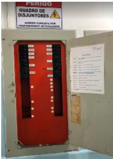
QUADRO DE DISJUNTORES
