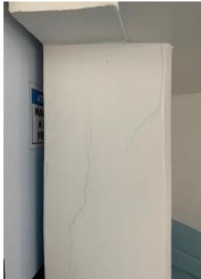
PILAR COM FISSURAS
