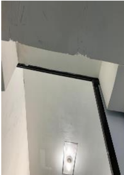
VIGA CORTADA ENFERMARIA
