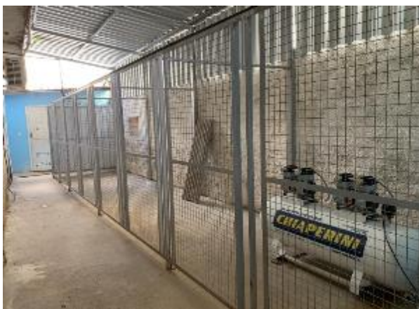
ÁREA DO COMPRESSOR
